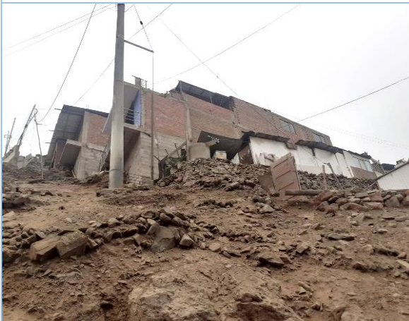
Foto N° 1: viviendas construidas sin seguir las normas técnicas, base inestable. Elementos expuestos: postes y cables de luz.
