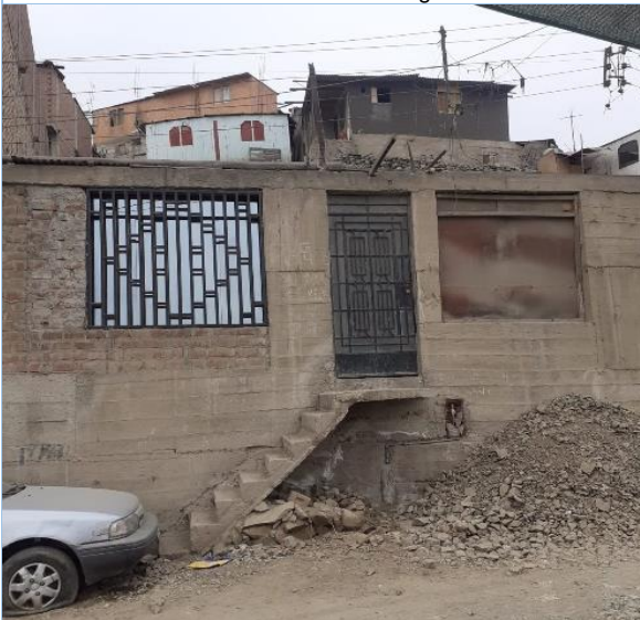
Foto N°3: presencia de desmonte frente a vivienda.
