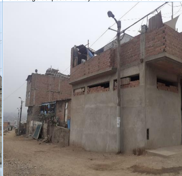
Foto N° 10: exposición de cables de luz con el segundo piso de la vivienda.
