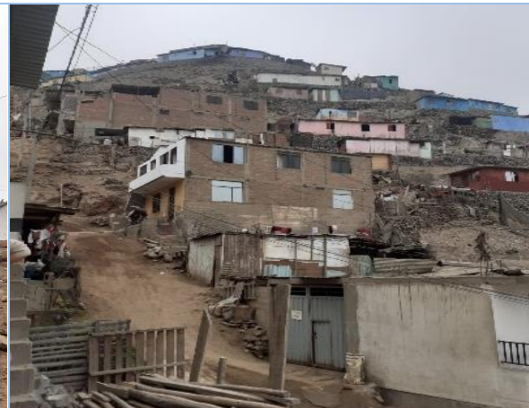
Foto N° 2: viviendas construidas sin seguir las normas técnicas, base inestable con llantas y rocas. Elementos expuestos: postes y cables de luz y viviendas en la parte inferior en caso de derrumbe.
