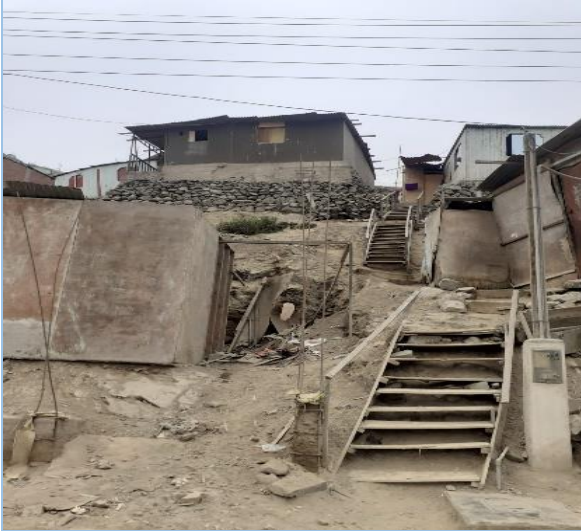
Foto N° 5: Mz G, viviendas precarias, abandonadas.
