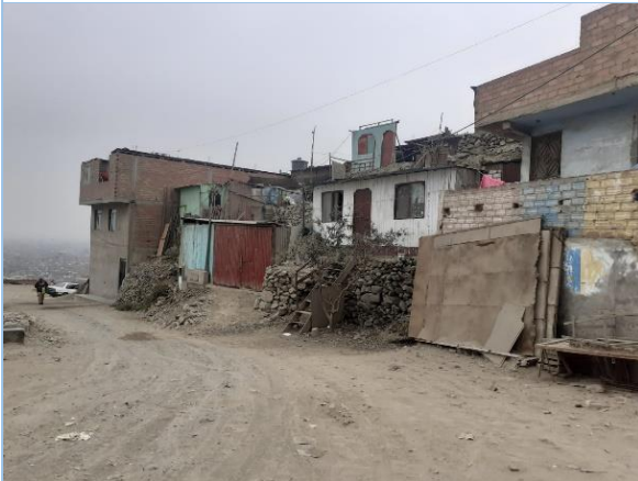
Foto N° 7: Mz A, Viviendas sobre base inestable de sistema de pirca.
