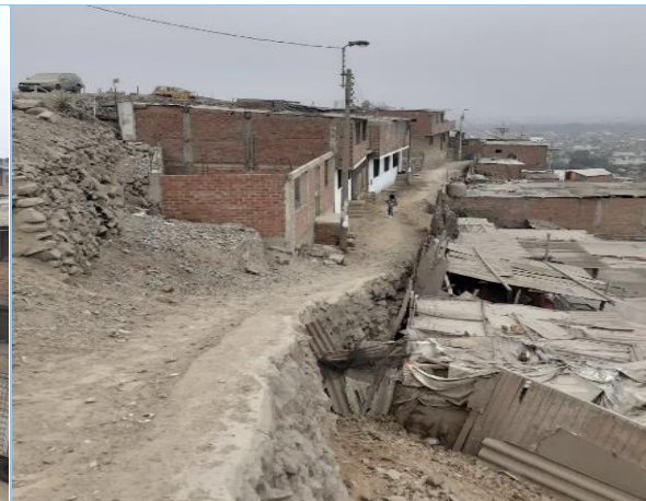
Foto N° 2: viviendas construidas sin seguir normas técnicas.
