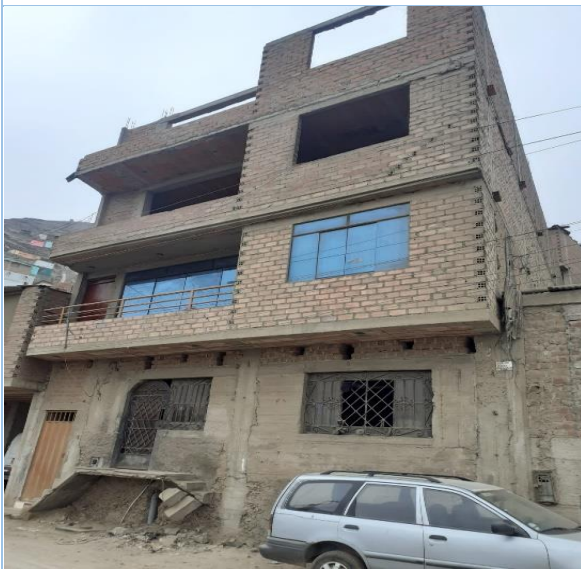
Foto N° 9: vivienda construida sin seguir normas técnicas de construcción. Estado de conservación regular.
