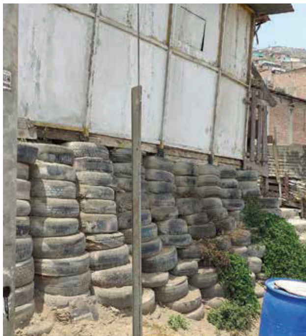
Viviendas livianas sobre la base del apilado de neumáticos, simplemente apoyados en el terreno. No se comportan como una unidad ante sismos.
