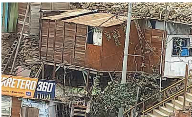
Vivienda liviana "tipo palafito" con estructura de madera que la soporta insuficiente para su peso. Su colapso afectará a otras viviendas vecinas.
