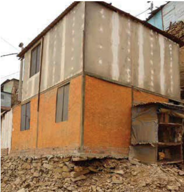
Viviendas livianas con materiales en muros y techos frágiles e inestables.
