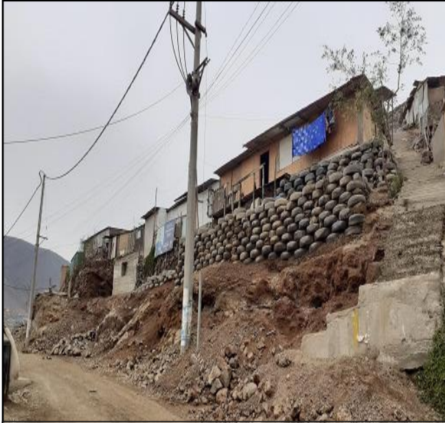
FOTO N°9: Vivienda sobre taludes inestables y la presencia de llantas sobre con material de relleno y sin muro de contención ante una probabilidad de ocurrencia de sismos de mayor magnitud, las viviendas podrían colapsar.
