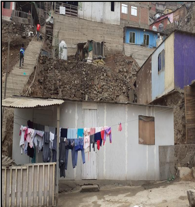
FOTO N°3: Se observa que la pendiente es fuertemente empinada y debido a la presencia de pircas inestables poco compactadas y debido a la ausencia de muro de contenciones podría producir caída de rocas.
