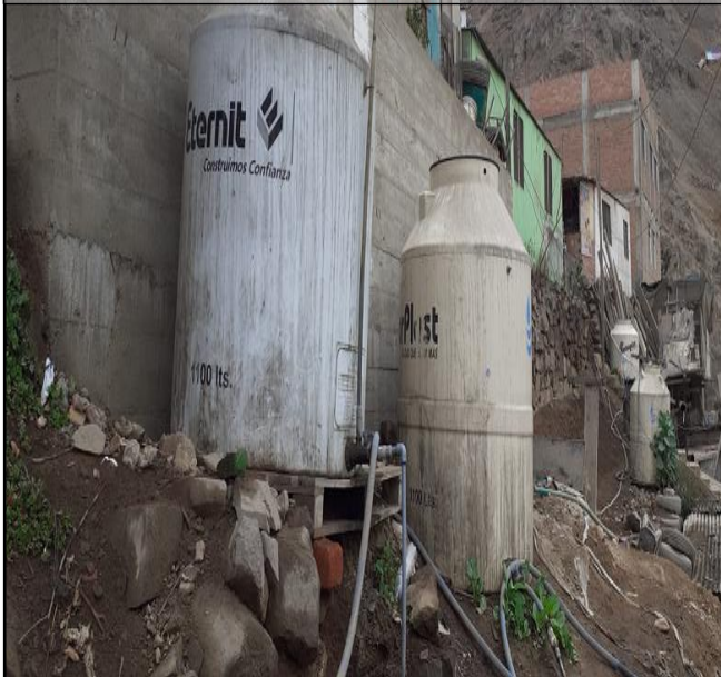
FOTO N°11: Se observa tanques de agua sobre bases precarias sin alguna base de cemento o sobre base sólida, de producirse un sismo de gran magnitud podrían colapsar por inestabilidad de los taludes y perjudicar a la otra vivienda colindante.
