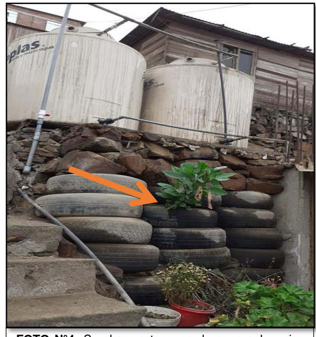
FOTO N°4: Se observa tanques de agua sobre piso pulido con bases de pircas y llantas poco compactadas sin ningún muro de contención, de producirse un sismo de gran magnitud podrían colapsar por inestabilidad de los taludes y perjudicar a la otra vivienda colindante.
